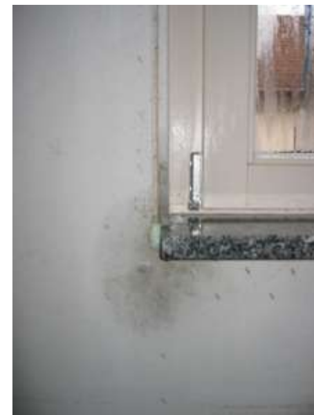
Конденсат уничтожил стену
