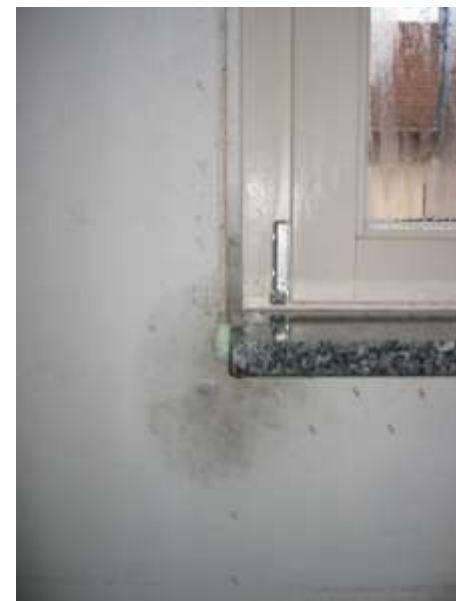
Конденсат уничтожил стену
